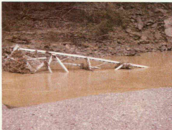
落橋した折立橋
